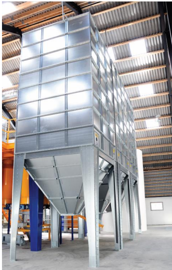
Figura 26. Nueva Tolva de almacenamiento.
