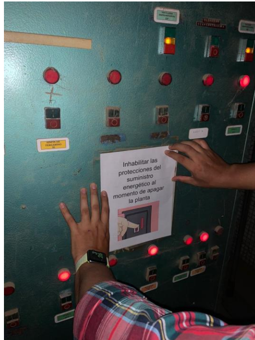
Inhabilitar protecciones de suministro energético al momento de apagado de la planta.
