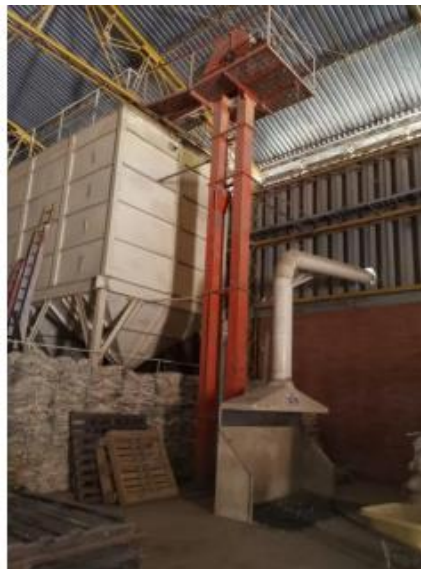
Figura 10. Malla y Tolvas de almacenamiento.
