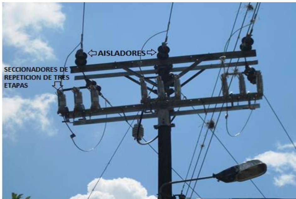
Figura 4.5. Configuración propuesta en poste red eléctrica comercial
