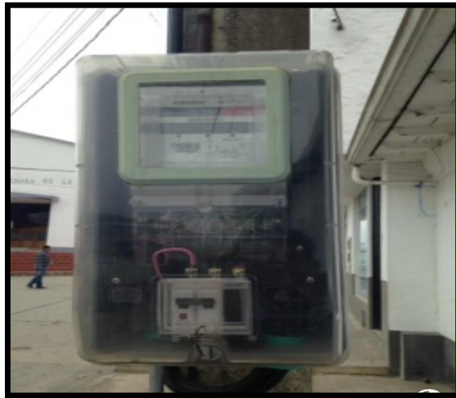
Figura 4.3. Medidor Bifásico para alumbrado instalado en el Municipio de la Paz - Santander.
