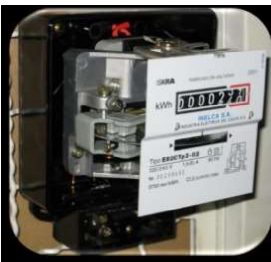
Figura N° 5. Equipo de medida con conexión directa a la red B.T.
