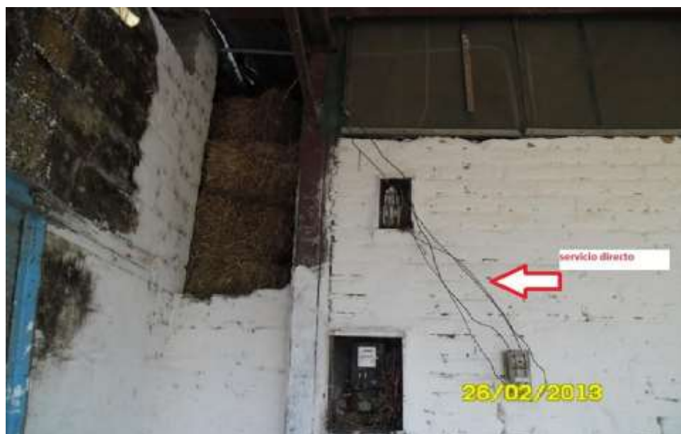
Figura N° 17. Servicio directo, conexión tomada de manera ilegal desde la red de distribución.
