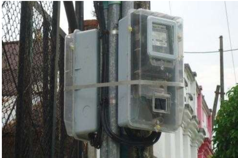
Figura N° 33. Medidor instalado en poste.
