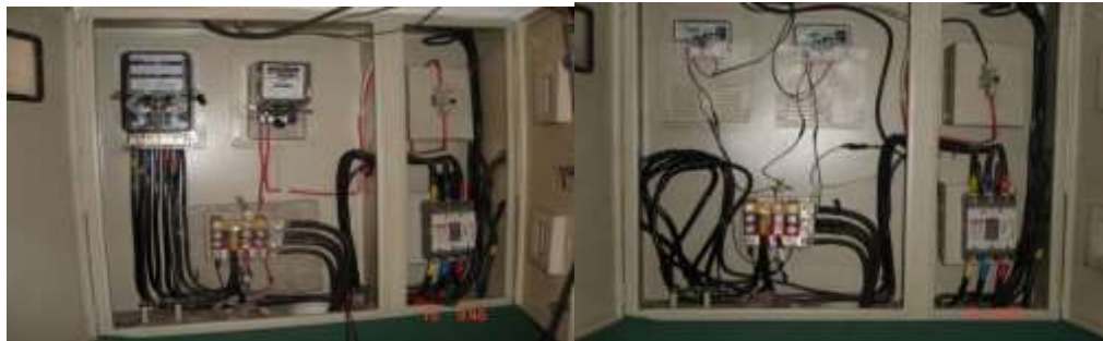
Figura N° 37. Medidor bicuerpo en modulo.
