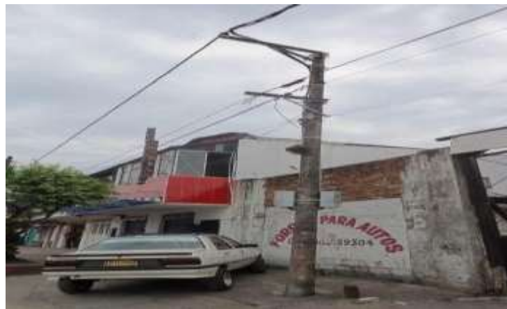
Figura N° 32. Utilización de crucetas en Baja tensión como sistema de control.
