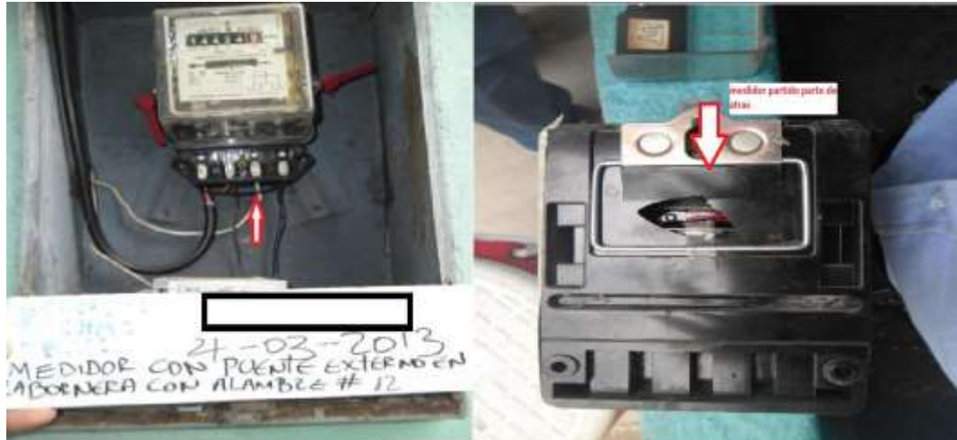
Figura N° 18. Medidor con conexión manipulada y perforación para alterar mecanismo.
