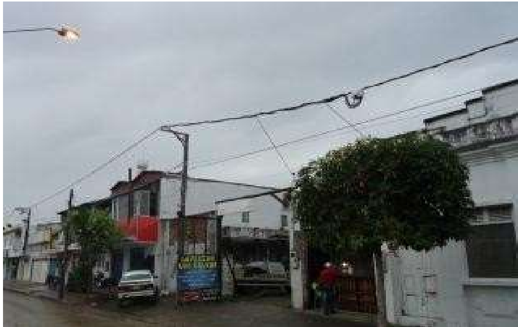
Figura N° 31. Utilización de Cable trébol en transformadores de altas perdidas.
