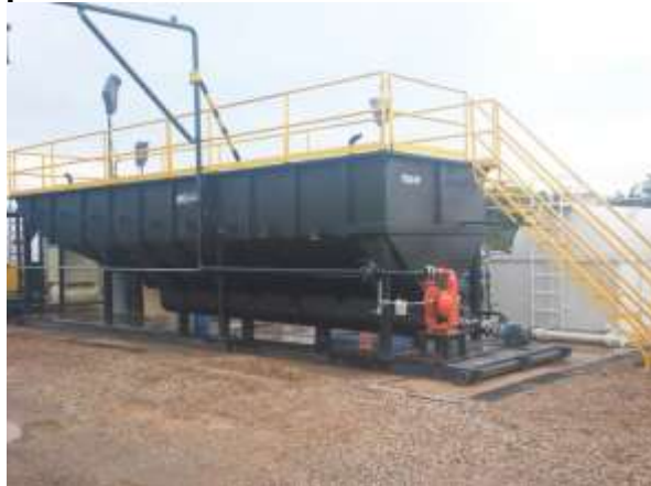
Ilustración 13. Tanque de lecho de secado
