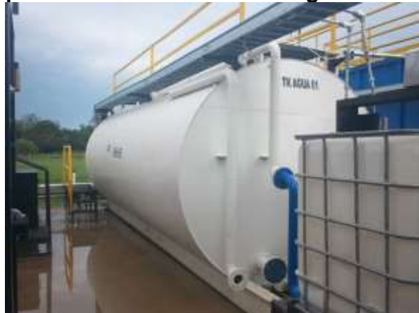
Ilustración 14. Tanque de almacenamiento de agua tratada
