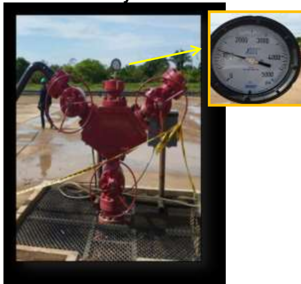
Ilustración 8. Cabezal o árbol de inyección
