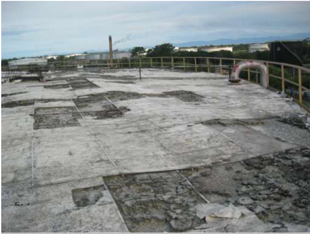
Figura 14. Fotografías estado aislamiento térmico techo K2501
