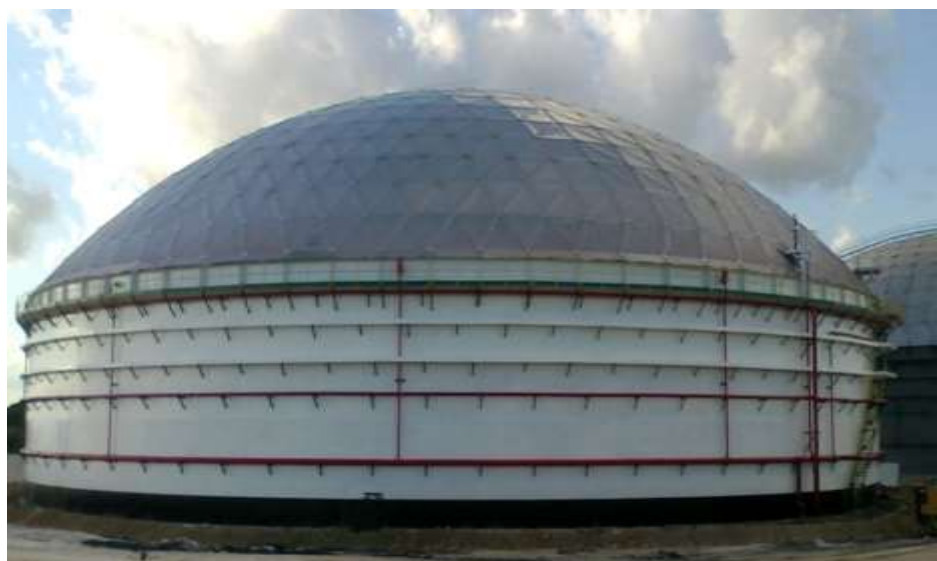
Figura No.2 Tanque geodésico
