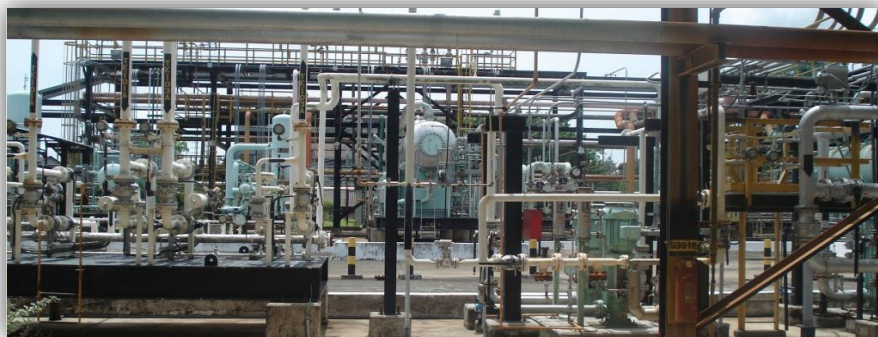
Figura 4: Tren de bombeo de productos blancos
