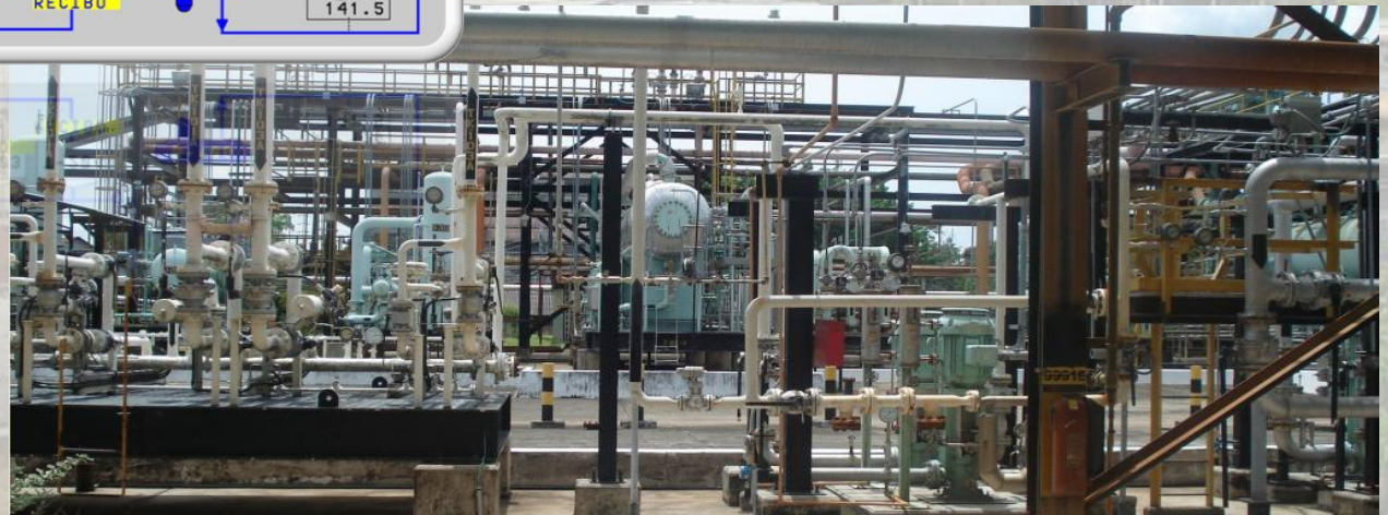
Tren de bombeo de productos blancos
