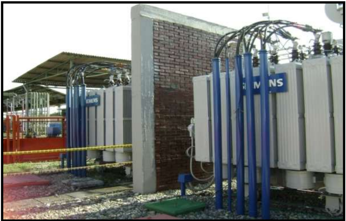
Figura 6. Subestación Eléctrica Planta Galán.
