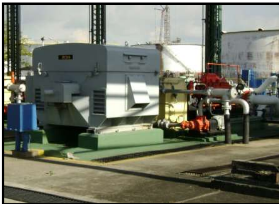
Figura 5. Unidades de Bombeo Estación Galán.
