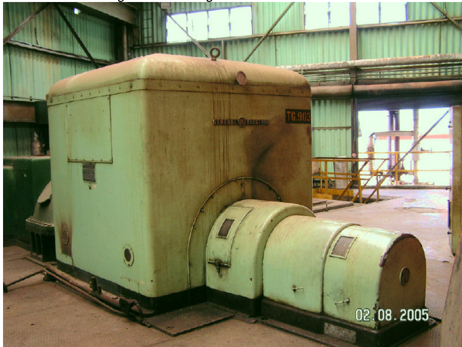
Figura 1. Turbogenerador actual en U900
