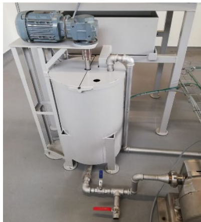
Figura 5. Tanque de mezcla. [1]
