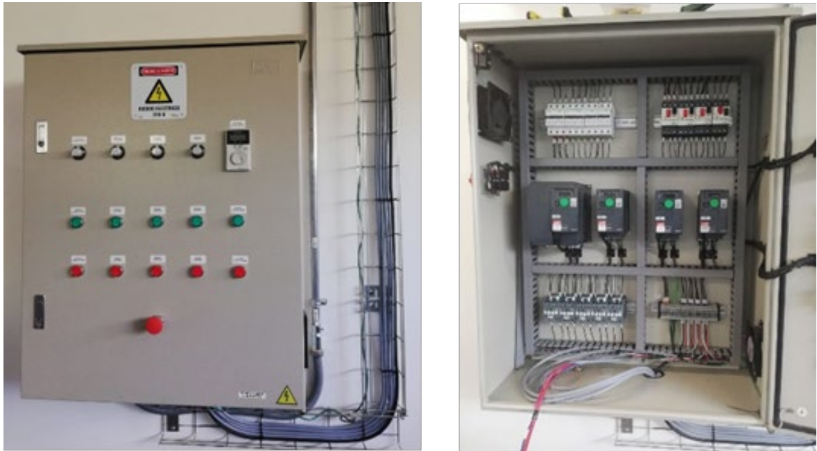
Figura 10. Tablero de Control.[1]
