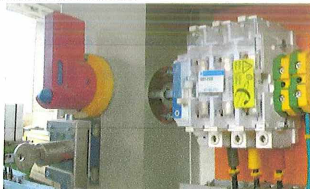
Figura 58. Seccionador de entrada.
