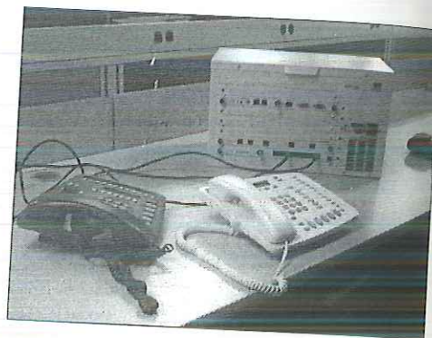
Fig. 4: Telefonía IP [Laboratorio de Telecomunicaciones UNAB].
