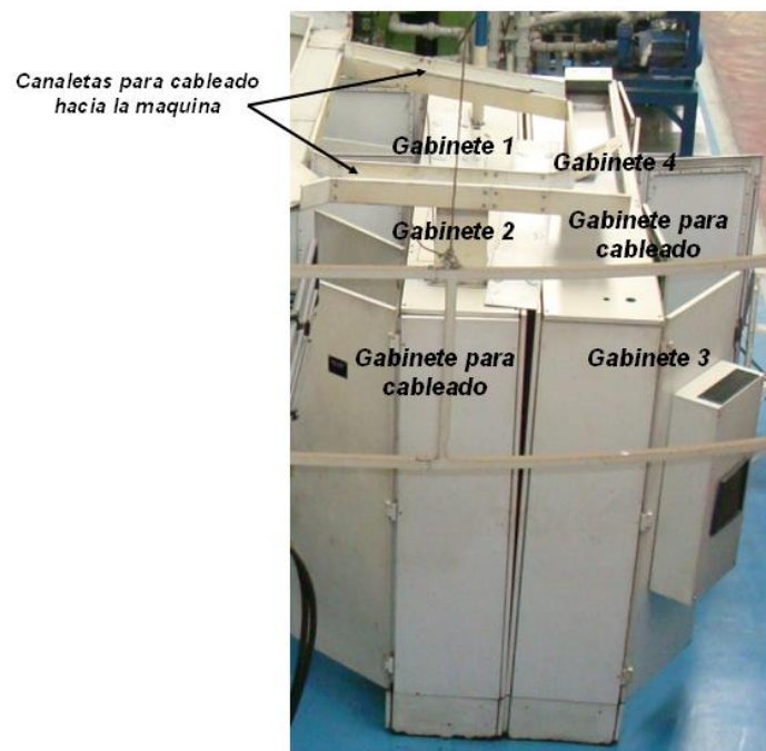
Figura 21. Vista lateral de la parte de conexiones eléctricas. Fuente: Autores.
