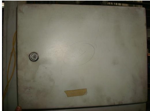
Figura 35. Vista externa del tablero 11. Fuente: Autores.
