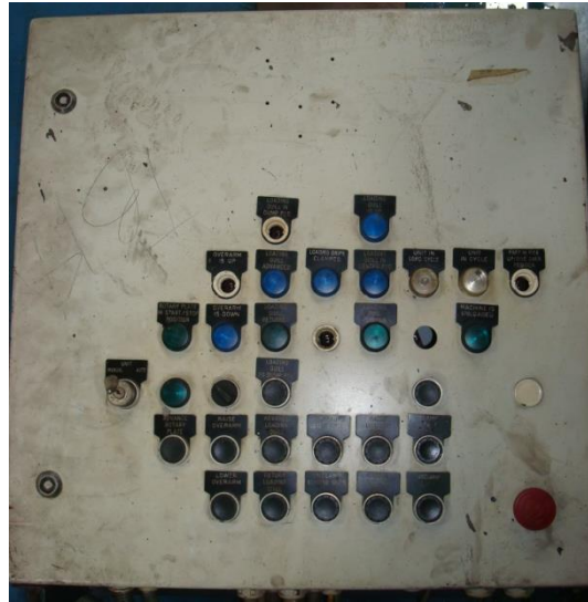
Figura 37. Vista externa del tablero 14.
