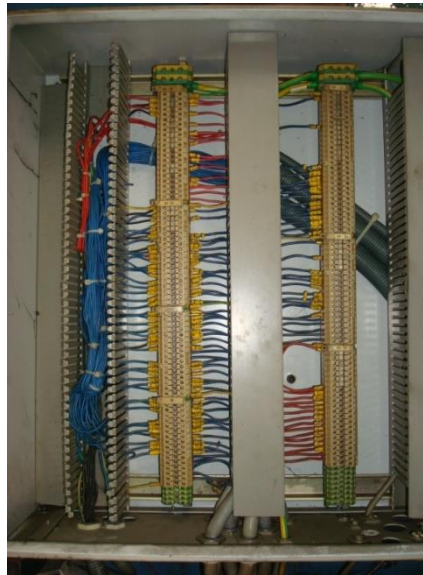
Figura 38. Vista interna del tablero 14. Fuente: Autores.
