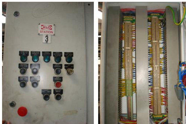
Figura 50. Vista general del tablero 20. Fuente: Autores.
