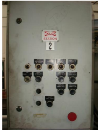
Figura 44. Vista externa del tablero 17. Fuente: Autores.
