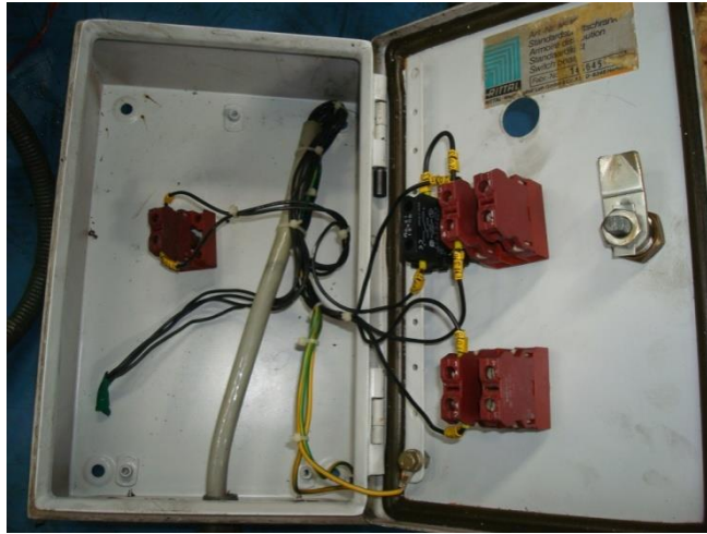
Figura 40. Vista interna del tablero 14/1.
