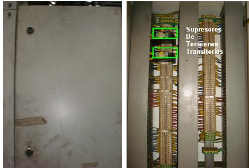
Figura 48. Vista general del tablero 19. Fuente: Autores.
