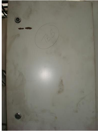
Figura 33. Vista externa del tablero 5. Fuente: Autores.
