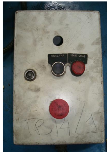
Figura 39. Vista externa del tablero 14/1. Fuente: Autores.
