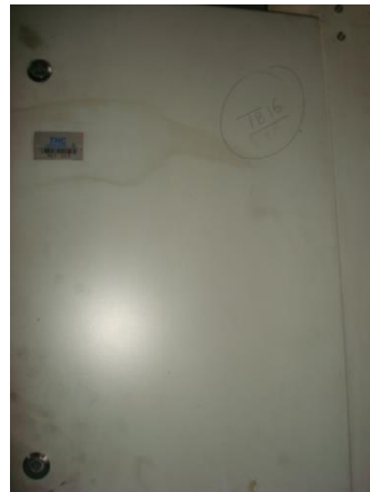
Figura 41. Vista externa del tablero 16.
