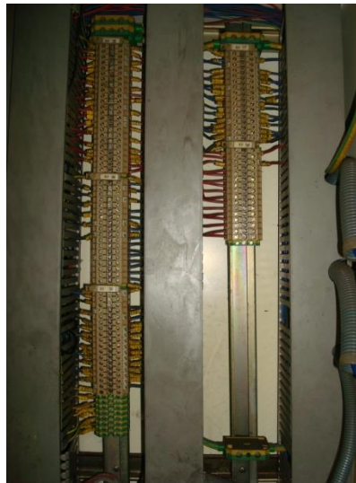
Figura 45. Vista interna del gabinete 17 Fuente: Autores.
